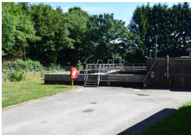
Kläranlage in Sülfeld
