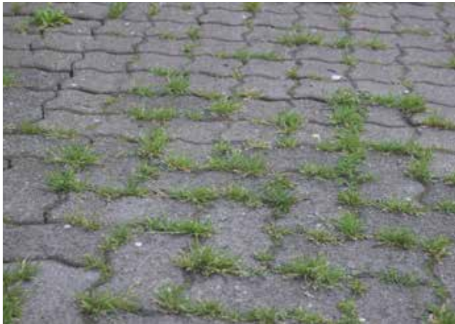
Unkraut zwischen Pflastersteinen vor der Heißwasserbehandlung
