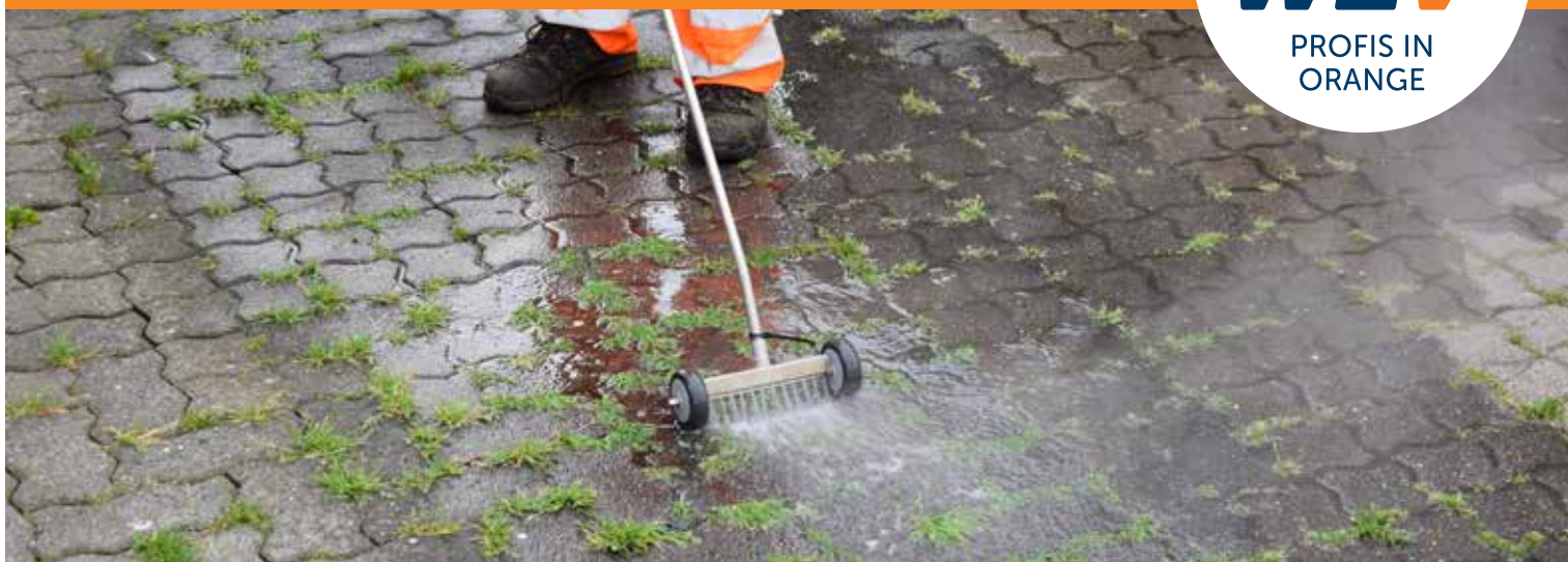
Das Heißwassergerät im Einsatz
